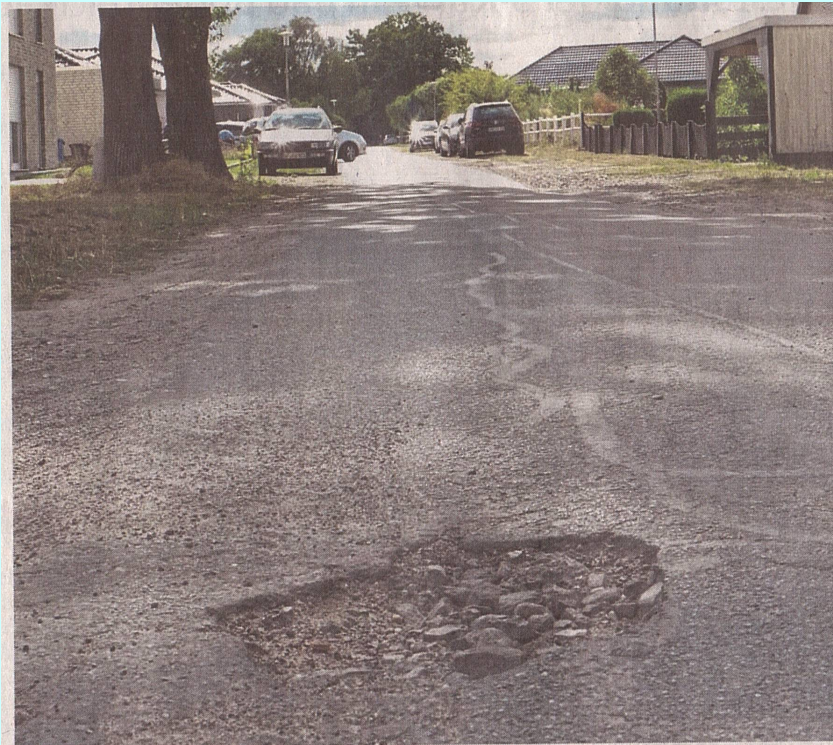
Die Straße Horst in Westerholz wird vorerst nicht ausgebaut, sondern repariert. Die Ausbausatzung wurde für zwei Jahre vom Gemeinderat ausgesetzt. FOTO: ARCHIV
